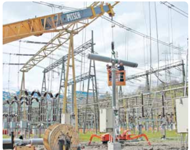
Obr. 1 Aj počas modernizácie musí byť prevádzka rozvodnej stanice zaistená bez prerušenia
