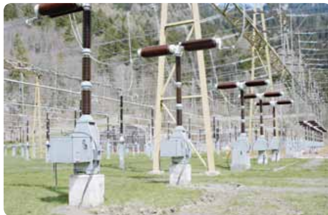
Obr. 4 Inštalované prerušovače čakajú na svoje pripojenie.
